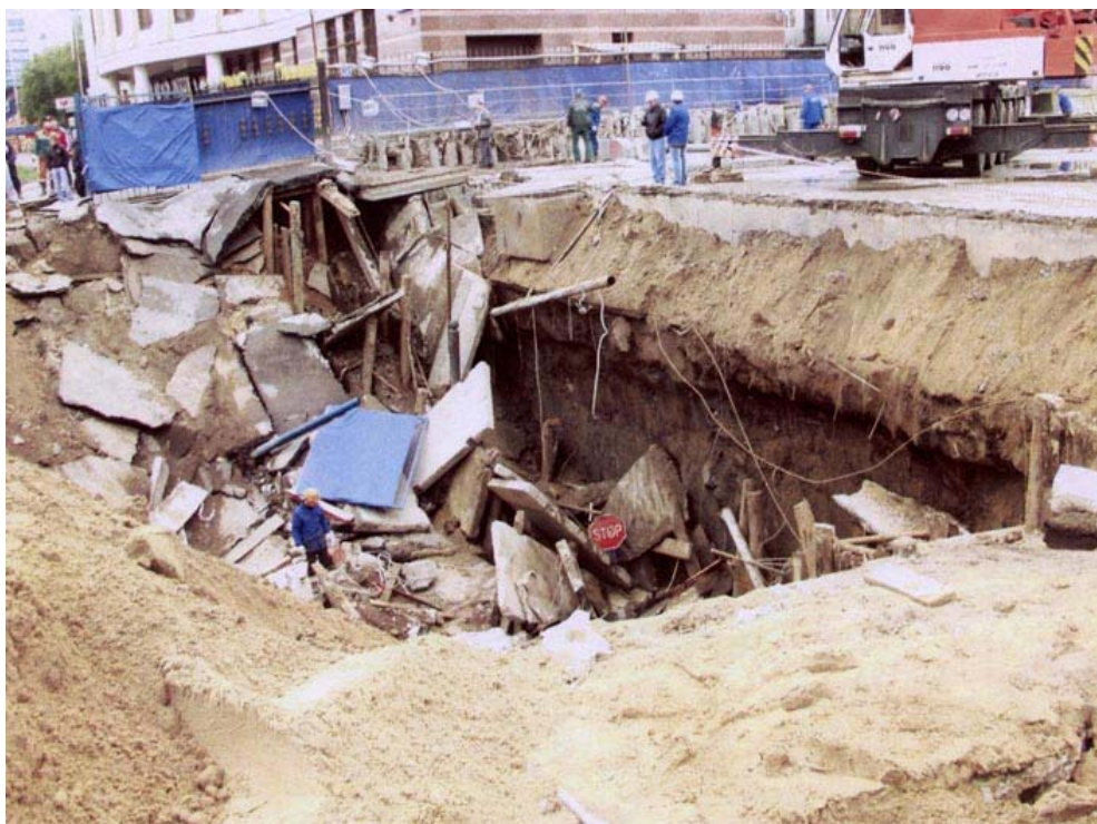
Рис. 14 . Провал грунта на Ленинградском проспекте.
