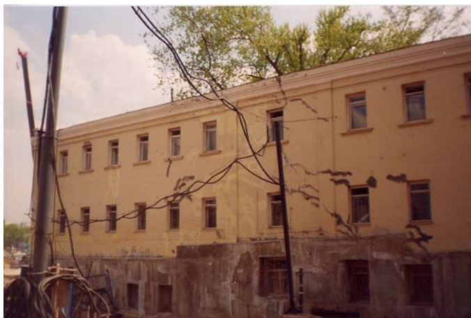
Рис.5 Здание по адресу: ул.Ладужская, 16,находящееся в зоне влияния котлована автодорожного тоннеля на участке 3-го транспортного кольца в Лефортово, после усиления его фундаментов буринъекционными сваями
