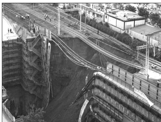
Рис. 3. Обрушение анкерного крепления котлована при строительстве тоннеля в Южной Корее.
