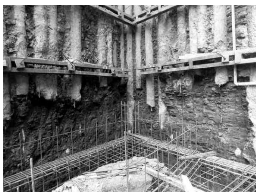
Рис. 49. Сваи ограждения не доведены до проектной отметки, что вызвало аварию (website).
