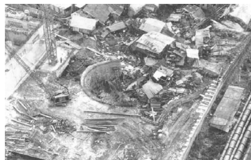
Рис. 12. Площадка насосной станции после аварии (Теракса и др., 1999).
