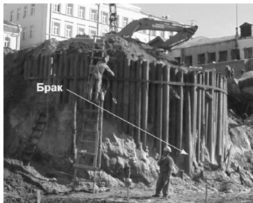
Рис. 48. Отклонение элемента ограждения от вертикали.
