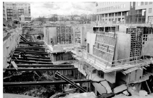
Рис. 30. Вид с угла обрушившейся стены котлована в Варшаве (Brandl, 2007).
