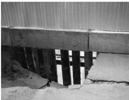
Рис. 2. Провал на проезжей части улицы в Москве при отсутствии забирки в ограждении котлована.
