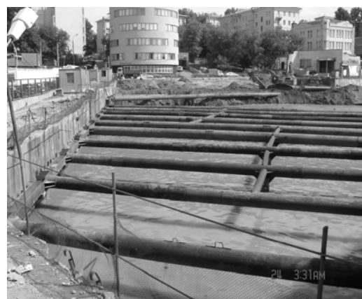
Рис. 38. Затопление котлована для предотвращения разрушения распорной системы.
