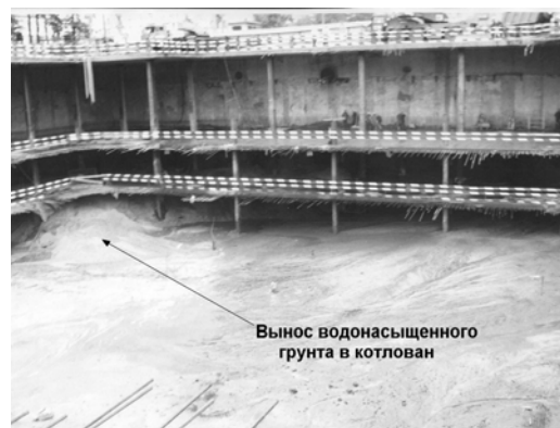
Рис. 31. Вынос водонасыщенного грунта в котлован сквозь стену в грунте.
