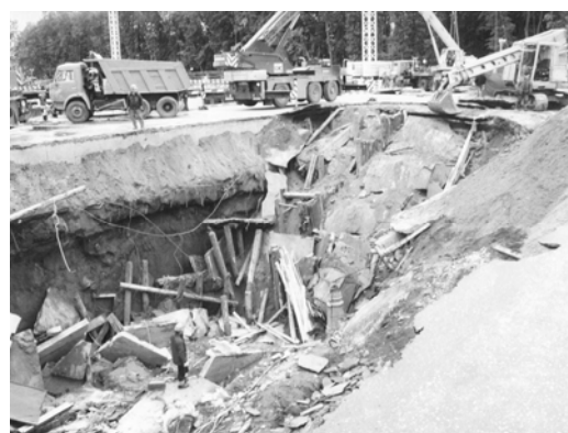
Рис. 32. Провал на проезжей части, вызванный выносом грунта в котлован (Колыбин, 2007).
