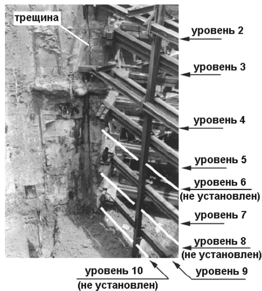
Рис. 14. Распорная система в точке «А» котлована за день до обрушения (Теракса и др., 1999).
