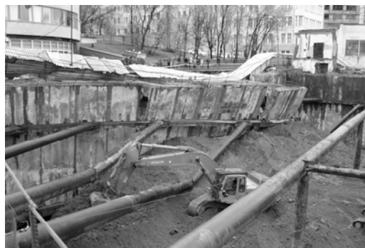
Рис. 35. Разрушение распорной системы и стены в грунте.
