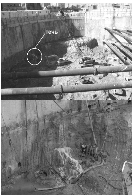
Рис. 41. Образование течи в стене в грунте при устройстве котлована Инфинити Тауэр (website).
