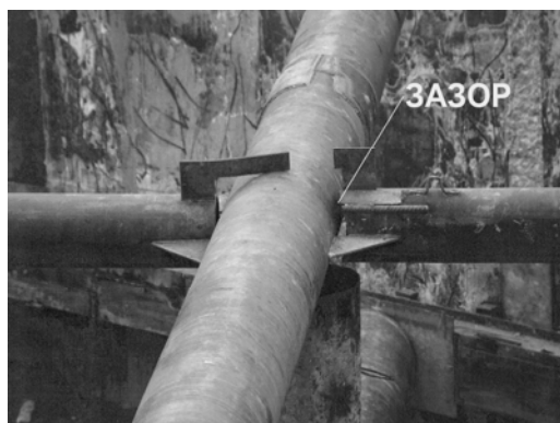
Рис. 50. Дефектный узел раскрепления распорки.
