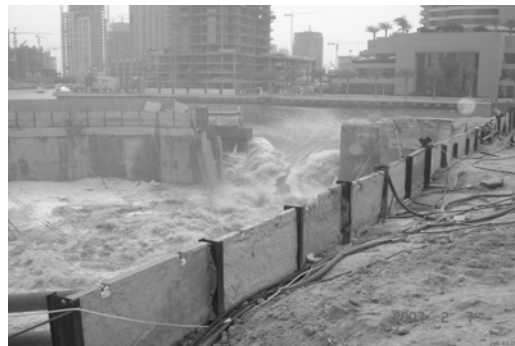
Рис. 42. Обрушение стены и затопление котлована в Дубае (Kuntsche, 2007).
