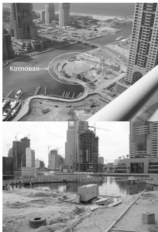
Рис. 43. Котлован Инфинити Тауэр после аварии (website).
