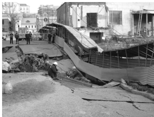
Рис. 36. Провал на проезжей части рядом с аварийным участком.
