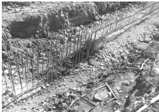
Рис. 4. Бракованная захватка стены в грунте в месте ухода свежего бетона.
