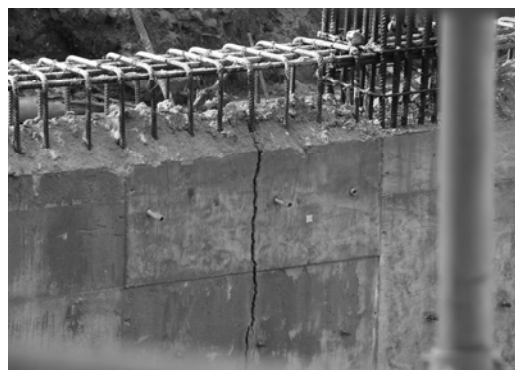
Рис. 52. Трещина в удерживающей обвязочной балке стены в грунте.
