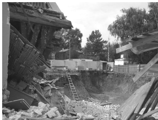
Рис. 1. Обрушение здания бывшего кадетского Корпуса в Нижнем Новгороде.
